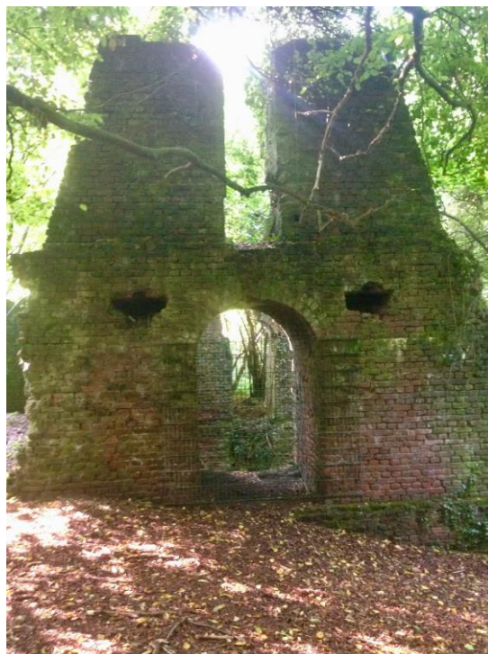
Einfahrt des Erzbergwerks aus dem 19. Jahrhundert im Korkuswald Nothberg/Hastenrath, heute aus Sicherheitsgründen eingezäunt (eigenes Bild des Autors aus den 1980er-Jahren)
